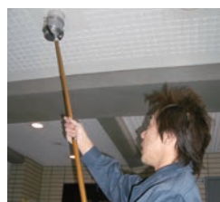
消防法定点検
