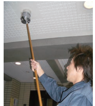
消防法定点検
